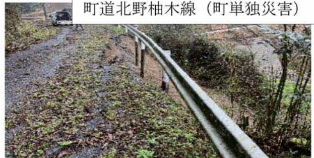
町道三本松岩上線（国庫負担災害）
