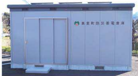
総合体育館駐車場 防災蓄電倉庫
