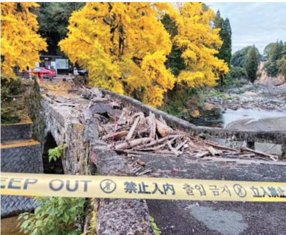
被災した二俣橋
