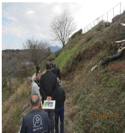
崩土箇所(カンントリーパーク)
