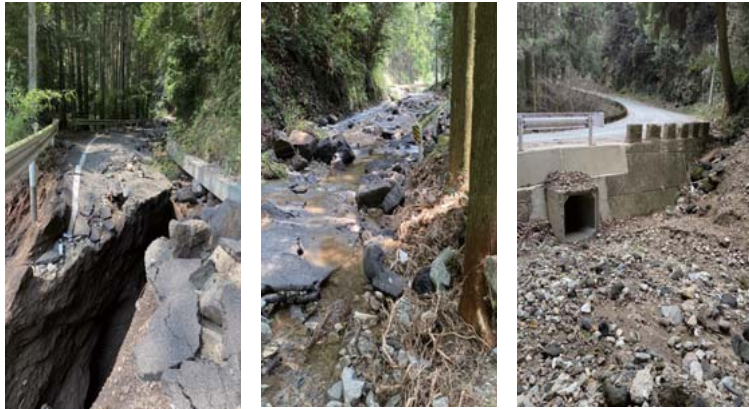
右写真の暗渠の詰まりが、中・左写真のような災害に (町道勢井下福良線)
