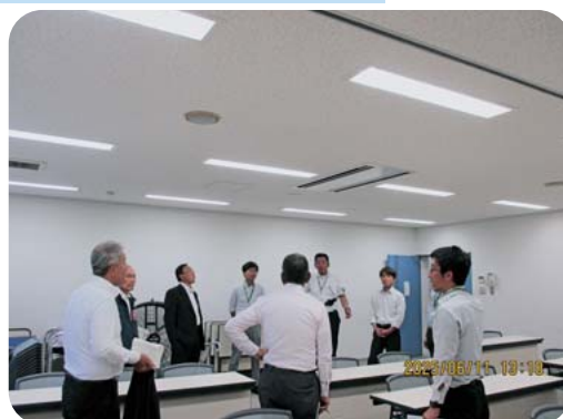
大研修室空調設備
