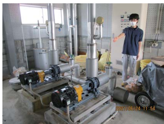
氷蓄熱冷房設備
