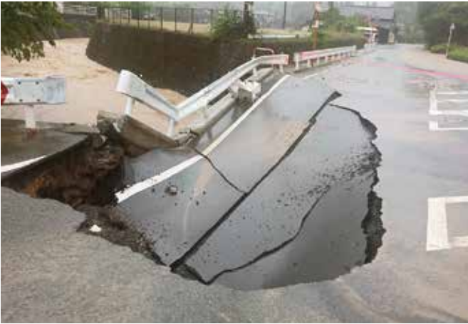
堂免谷橋(町道土喰大窪線)被災直後 路面が大きく崩落し寸断された状態
