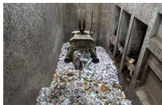
宇城クリーンセンターごみピット内
