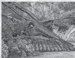
令和7年8月豪雨による宝勝寺観音堂被災状況②
