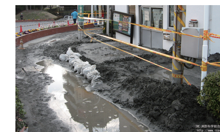
東日本大震災での液状化被害 ((一財) 消防防災科学センター)
