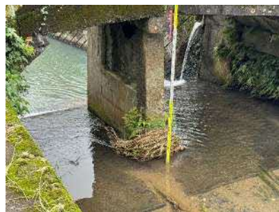
写真-2.2 宮の前橋断面障害状況
