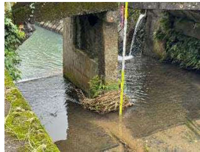
写真-2.2 宮の前橋断面障害状況
