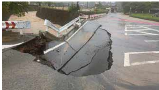
町道目磨永富線被害状況
