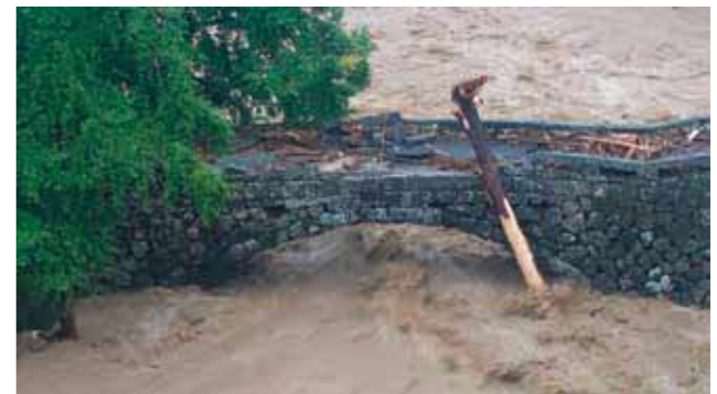
二俣橋被害状況
