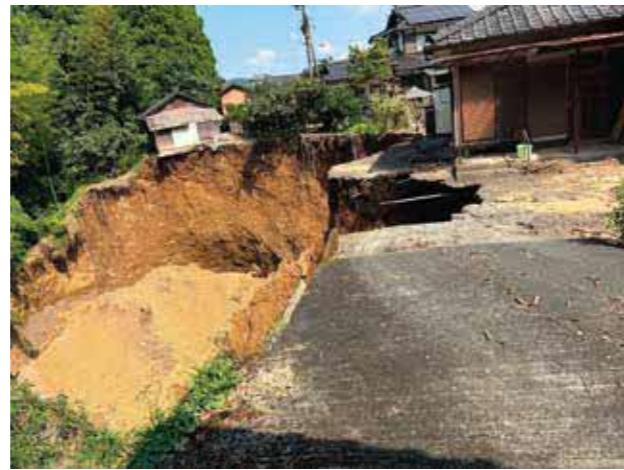
宅地内被害状況（安部地区）
