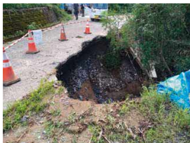
県道困砥用線被害状況
