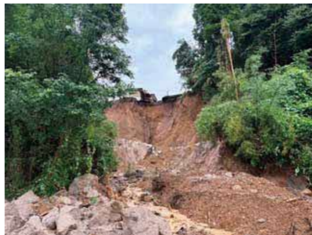
国道 445 号線被害状況
