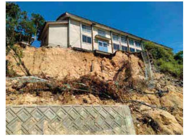
西分館南側法面被害状況
