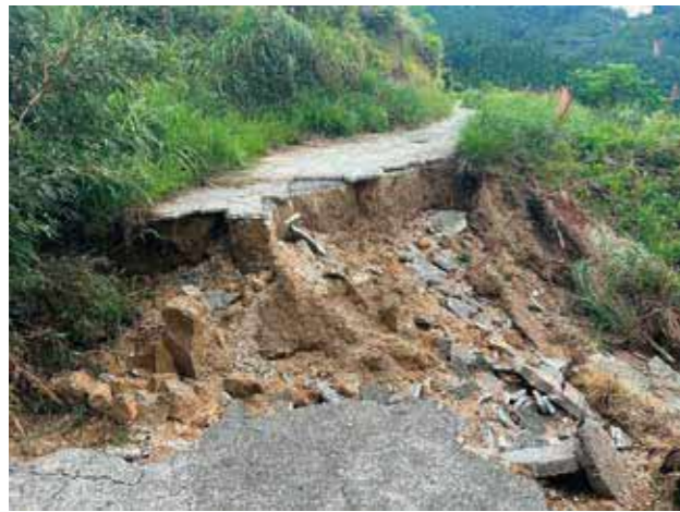
町道金木小崎線被害状況
