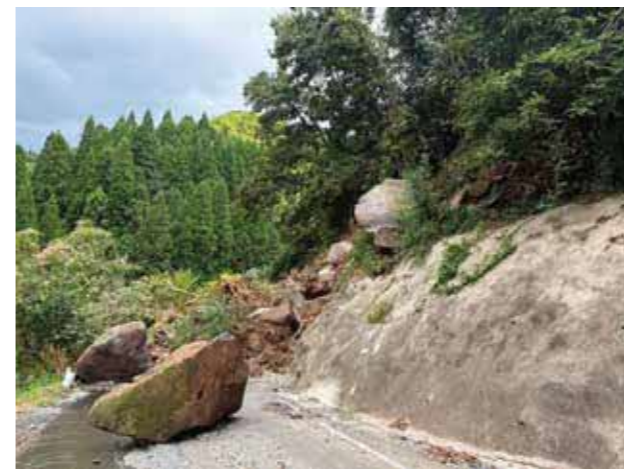
町道貫平五ヶ瀬線被害状況
