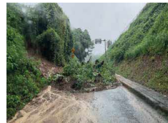
町道内山安部線被害状況
