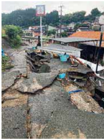
町道土喰一の谷線被害状況
