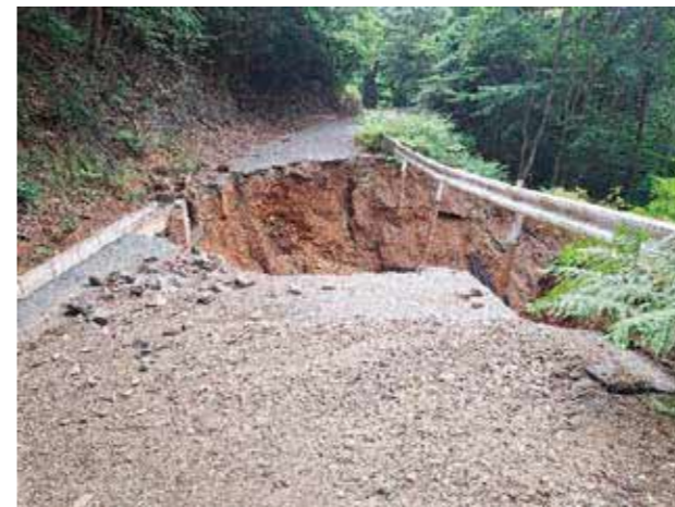
林道中央砥用線被害状況
