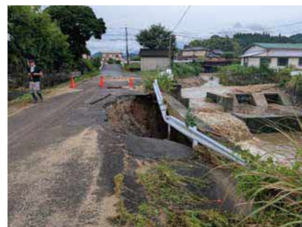
町道馬場神園線被害状況
