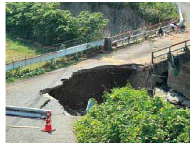
町道目磨坂貫線被害状況
