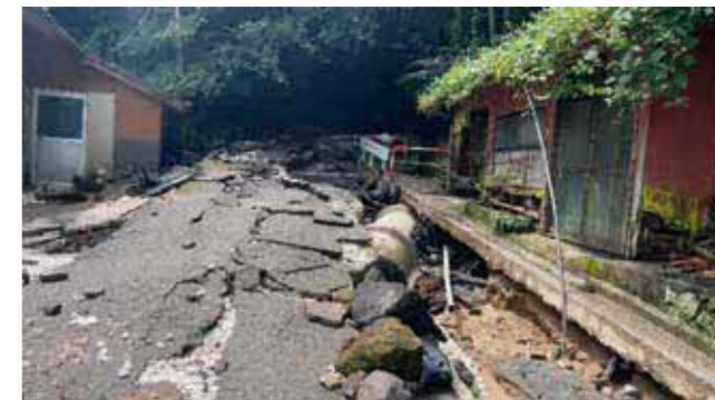
町道小筵・長尾野線被害状況
