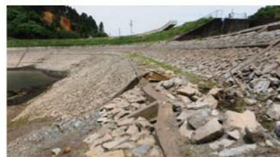
大切畑ため池における法面圧縮崩壊の様子(株式会社パスコ撮影)
